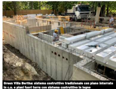
Green Villa Bertha: sistema costruttivo tradizionale con piano interrato in c.a. e piani fuori terra con sistema costruttivo in legno
